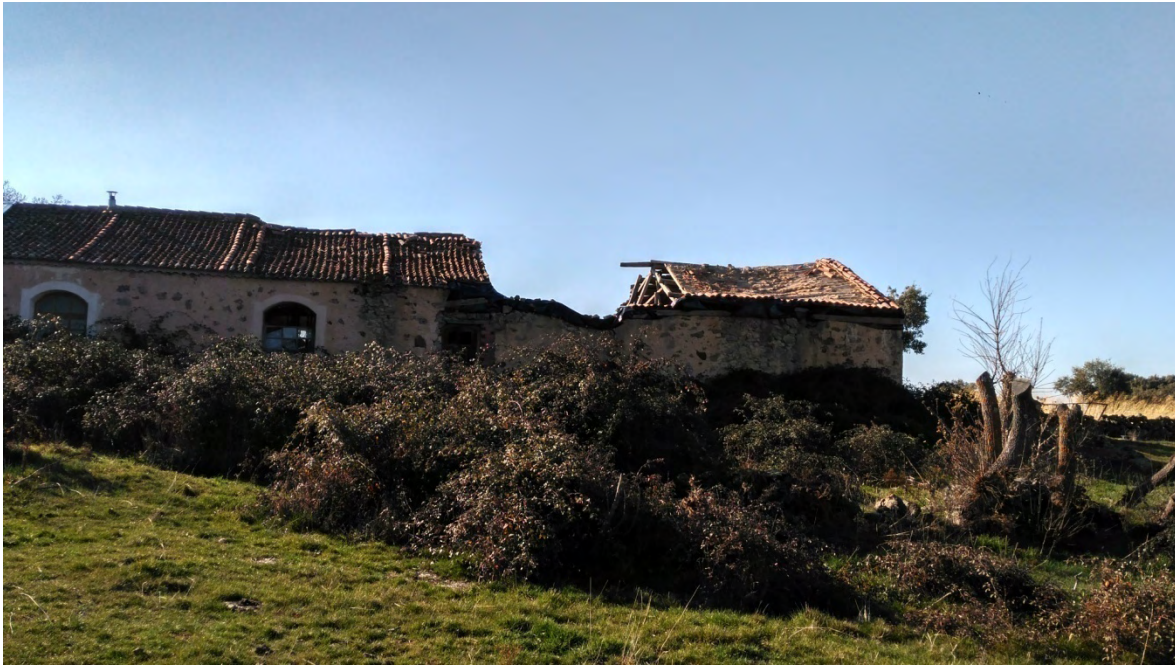
Fachada norte. Volumen con parte de la cubierta derrumbada.
