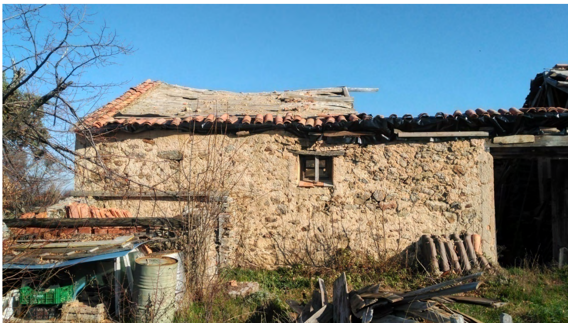
Vista de la zona donde la cubierta está parcialmente caída, en la zona coincidente con la puerta de acceso.
