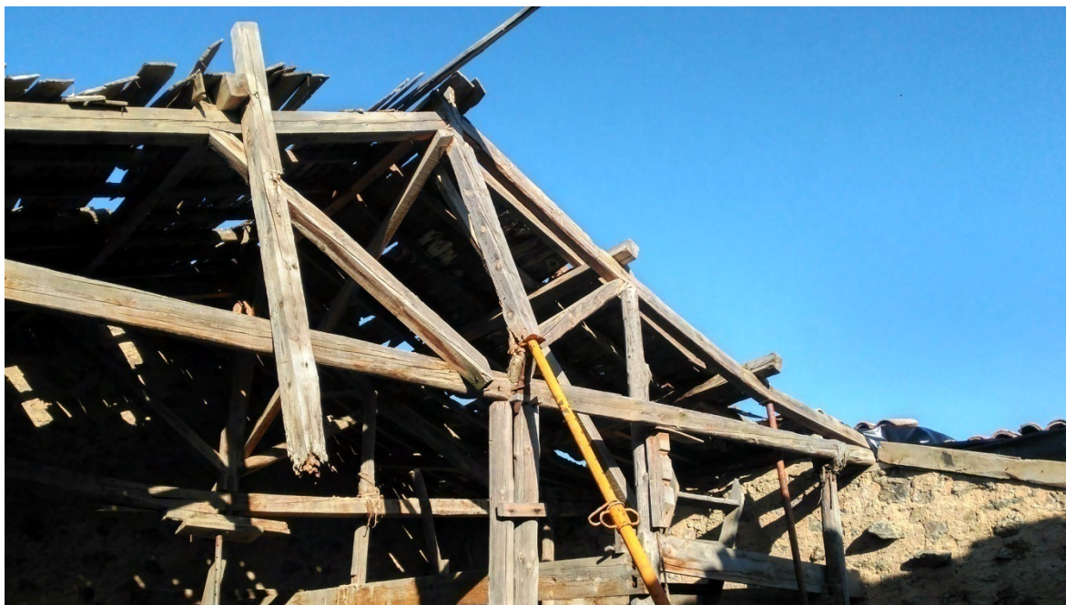
Detalle de las cerchas de madera existentes en la parte que se ha derrumbado.
